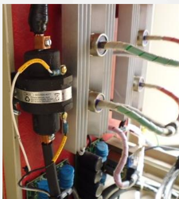
Relé instalado al interior de la Unidad Rectificadora
